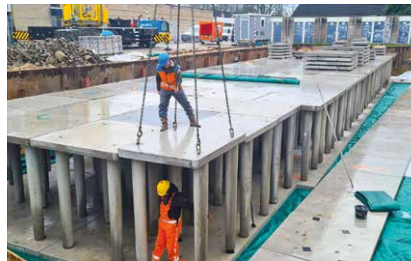
⬆ Tijdens de reconstructie van het centrum zijn verschillende infiltratiekelders gebouwd
